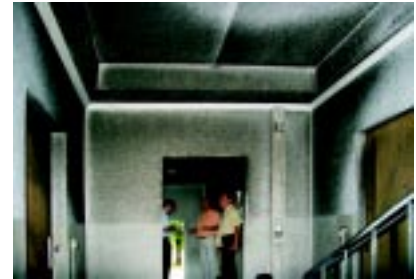
Brandschäden in der Dresdner Straße 297
